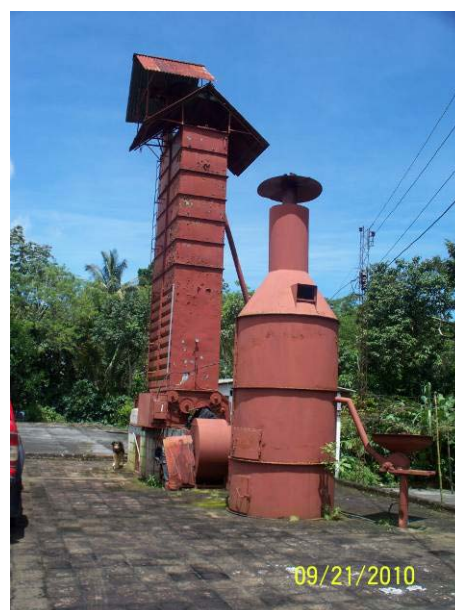
Instalaciones del beneficio ecológico
