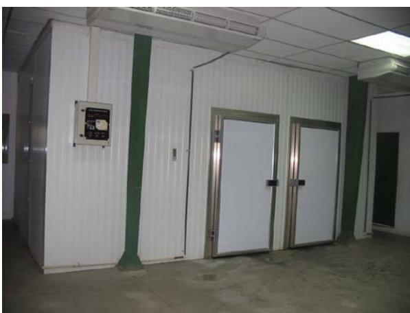
Cámaras de refrigeración
